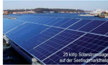
The solar power system in Kiel
